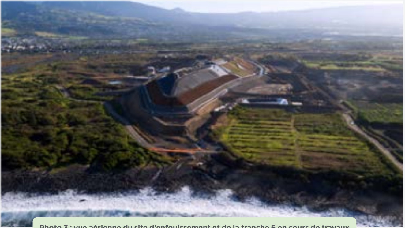
Photo 3 : vue aérienne du site d'enfouissement et de la tranche 6 en cours de travaux
