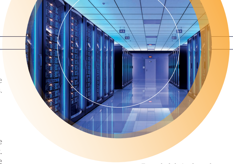
Exemple de baies de stockage dans un centre de données
