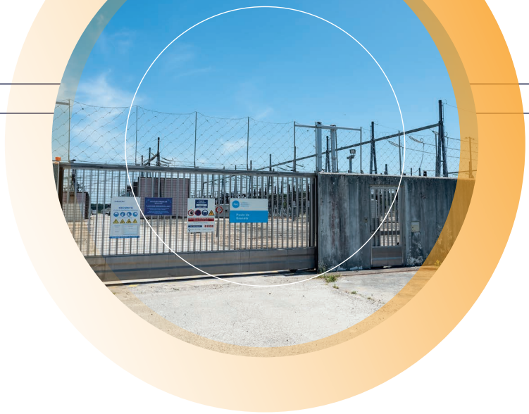
Poste électrique de Saucats (2021)
