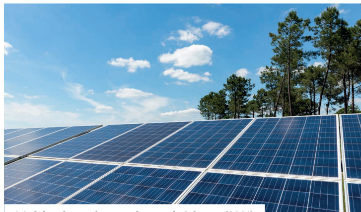
Modules photovoltaïques du parc de Salaunes (2021)
