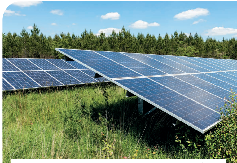
Photographie de panneaux photovoltaïques du parc de Salaunes (2021)
