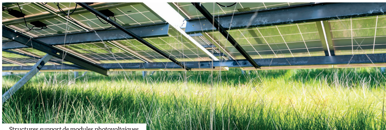
Structures support de modules photovoltaïques du parc de Salaunes (2021)
