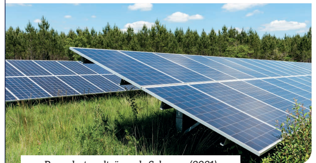
Parc photovoltaïque de Salaunes (2021)
