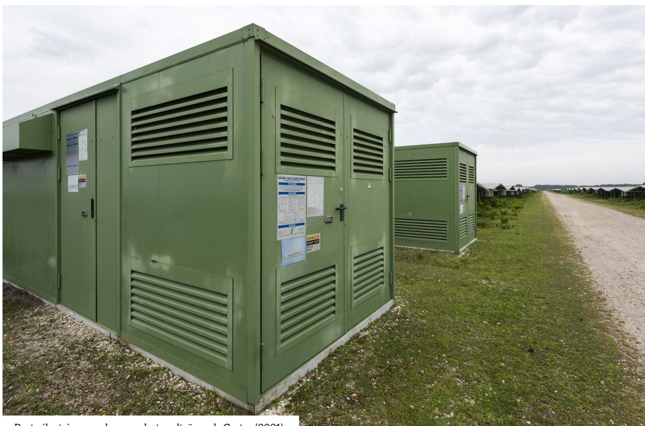
Poste électrique sur le parc photovoltaïque de Cestas (2021)
