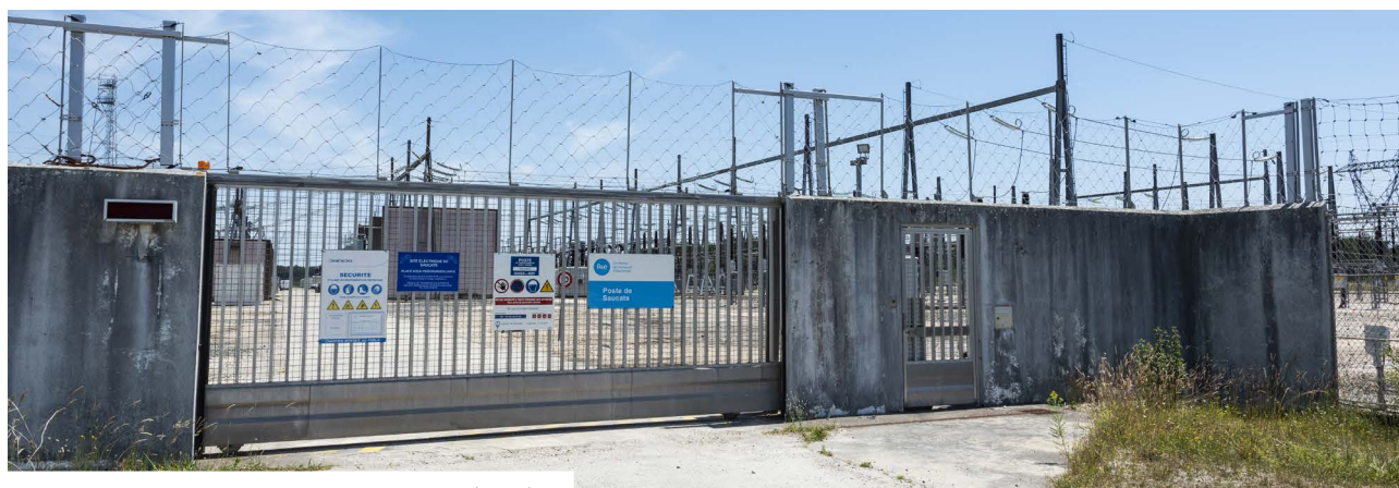
Photographie du poste électrique de Saucats (2021)
