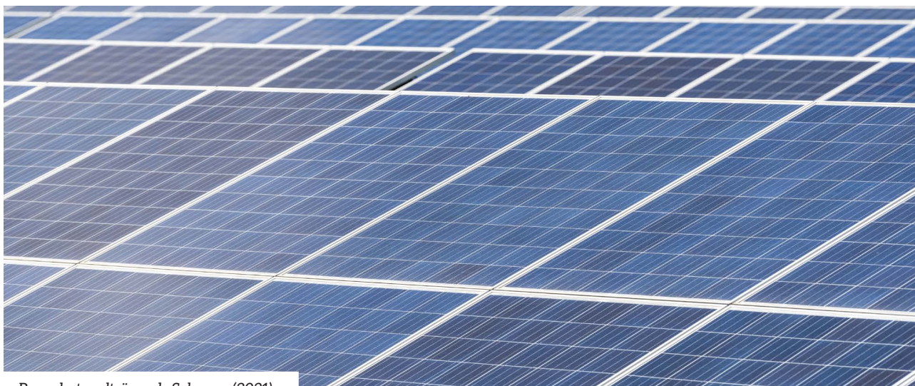
Parc photovoltaïque de Salaunes (2021)
