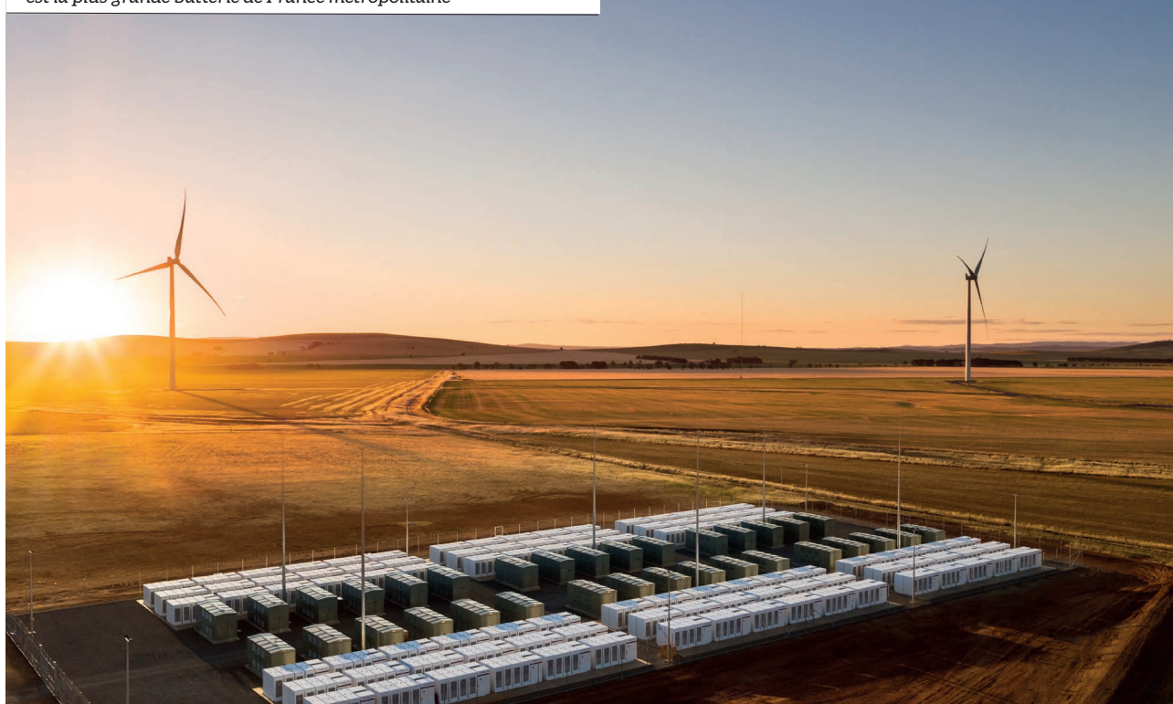
La "Hornsdale Power reserve" (Australie) permet depuis 2017 de fournir des services essentiels de soutien au réseau australien concurrençant les générateurs conventionnels fortement émetteurs de CO 2
