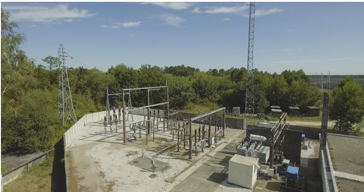
Le poste électrique d'Hostens (33)
