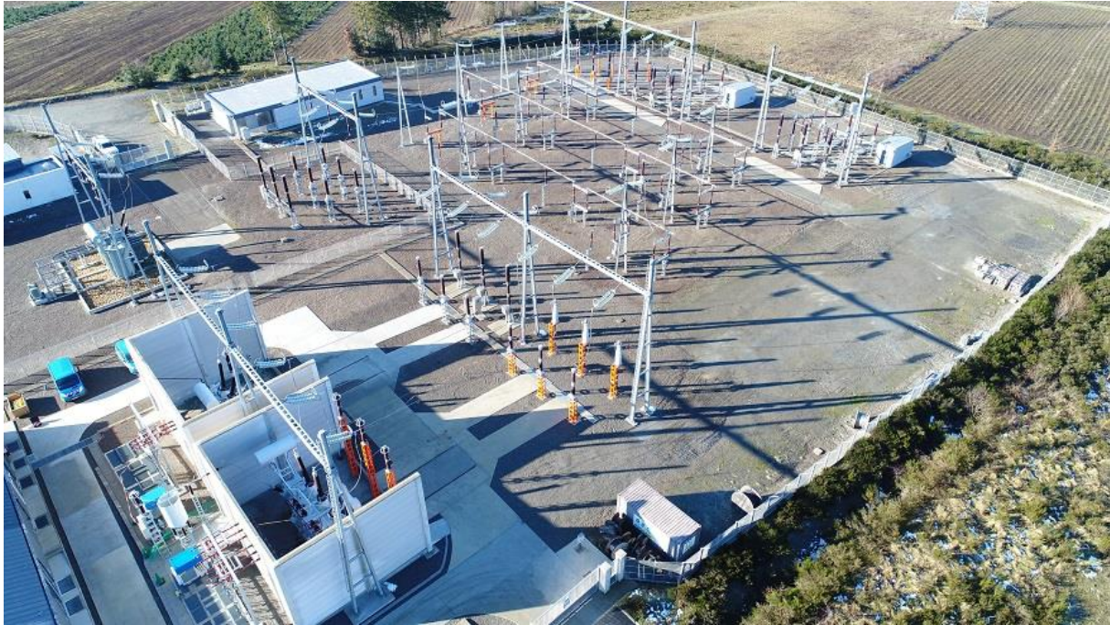
Vue d'un poste source électrique (Enedis)
