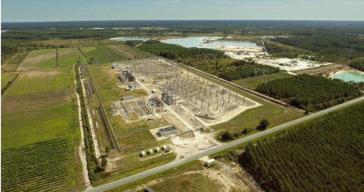
Le poste électrique de Saucats (33)
