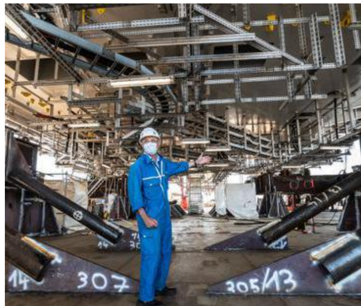
Frédéric Grizaud, directeur Énergies marines et ingénierie des Chantiers de l'Atlantique, sous le ventre de la sous-station électrique du parc éolien en mer de Saint-Nazaire
