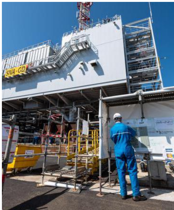
La sous-station de la centrale éolienne en mer du parc de Saint-Nazaire, un petit immeuble de 2 000 tonnes. XAVIER LEOTY
