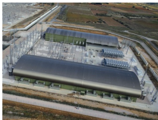
Stations de conversion de Baixas (320 kV)
