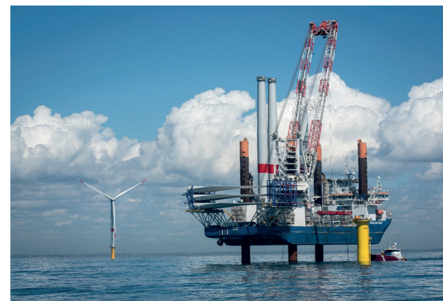
Parc éolien en mer de Saint Nazaire (avril 2022)
