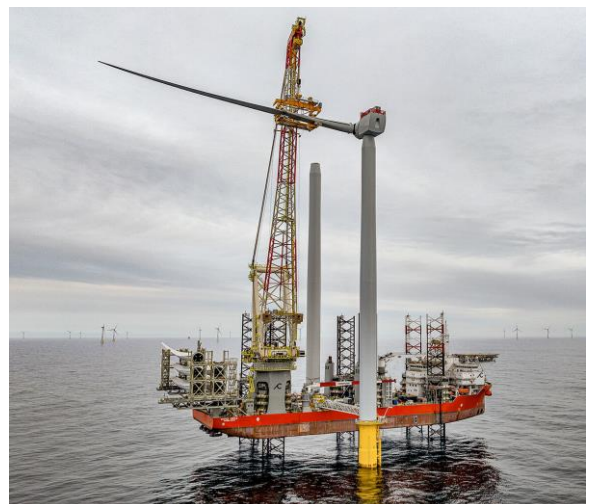
Figure 2 – Installation de la première éolienne du parc éolien OW de Moray West, Ecosse, Avril 2024. (d'une puissance de 14.7 MW, il s'agit de la plus puissante éolienne en mer d'Europe) Crédits : OW
