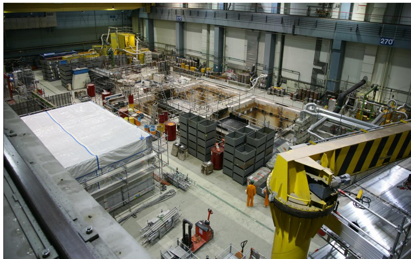
Centre de traitement des déchets dans le hall des turbines de la centrale nucléaire de Würgassen (réacteur à eau bouillante)
