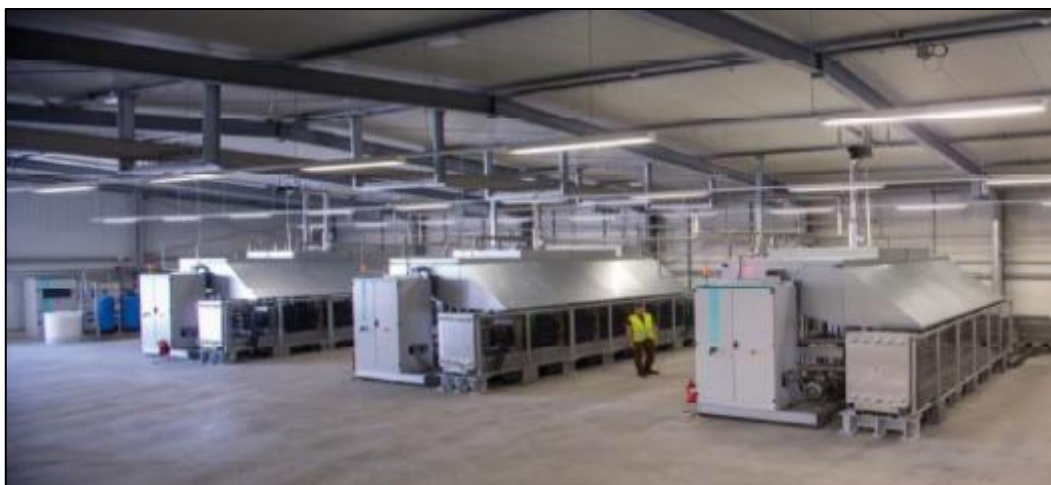
Source : Electrolyseurs PEM Siemens (Site de Mainz – Allemagne)
