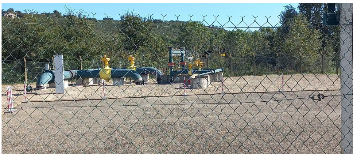
Postes de coupure et de sectionnement (source : NaTran)
