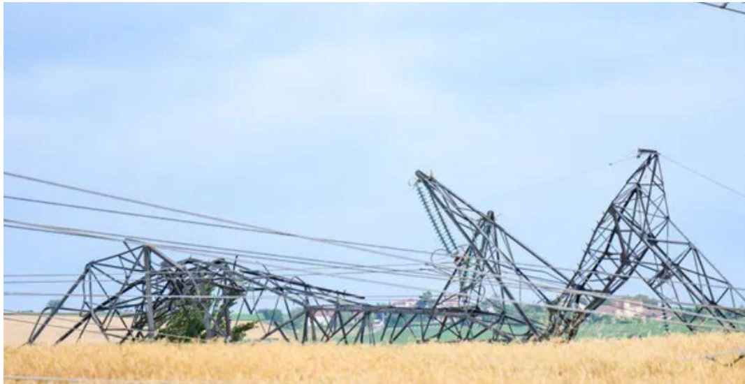
Dégâts d'un orage du 25 juin 2025 - secteur de Saint-Pourçain-sur-Sioule
