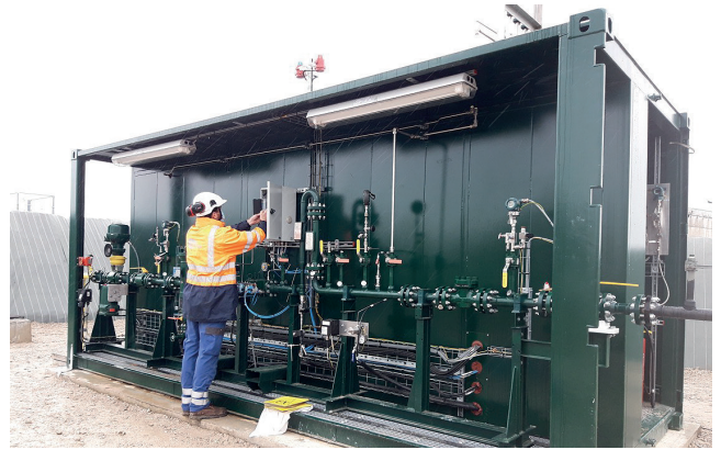
Exemple d'un poste d'injection de Bio-méthane (Crédit photo NaTran)
