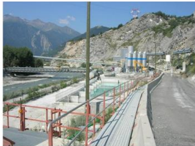
Installation de traitement des eaux de chantier, Modane, 73 (source : CETU)
