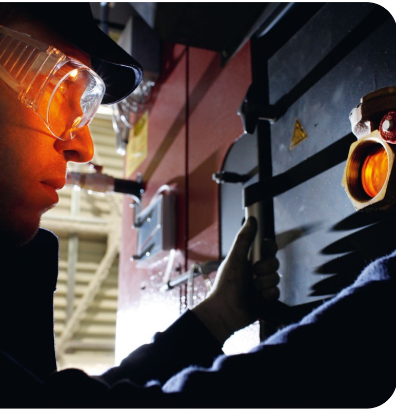
Technicien d'exploitation effectuant un contrôle visuel de la combustion à l'intérieur de la chaudière dans la chaufferie biomasse de Mazamet © Rodolphe Escher / Dalkia
