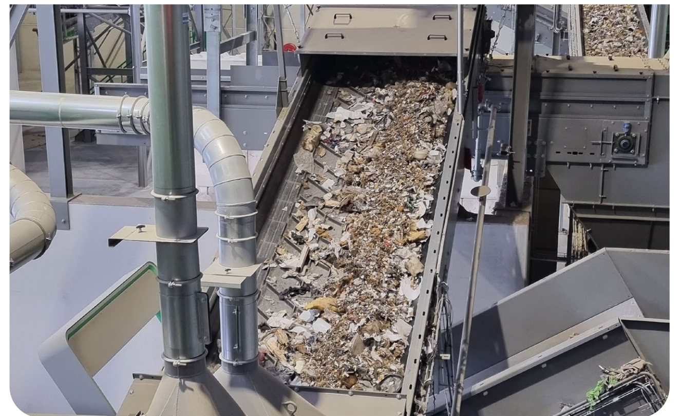
Unité de préparation et de production de combustibles solides de récupération (CSR) à Lannemezan (65) © Dalkia
