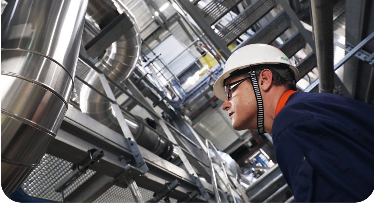
Technicien effectuant une ronde de contrôle à l'intérieur des bâtiments de la chaufferie biomasse de Surville © François Fèvre / Dalkia
